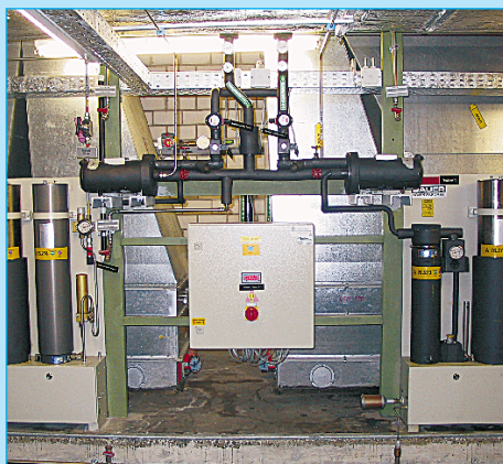
HD-Kompressor mit Trockner Seccant IVA, Aktivkohleabsorber, Wärmetauscher und Online Taupunkthygrometer ■
